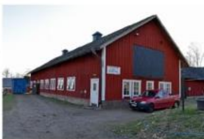
Stallet har inte renoverats sedan 1987 då Hylte rittarforening flyttade in. Ventilationsen är en av de brister som behöver åtgärdas akut.
